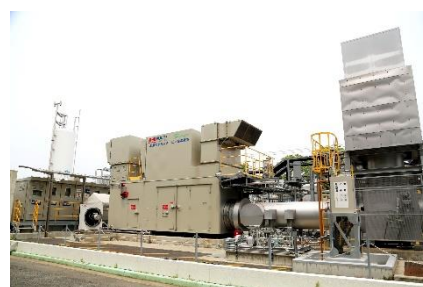
水素 CGS 実証プラント
